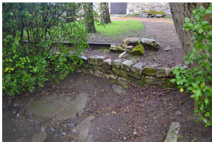
La collecte des eaux (ouvrages en pierre)
